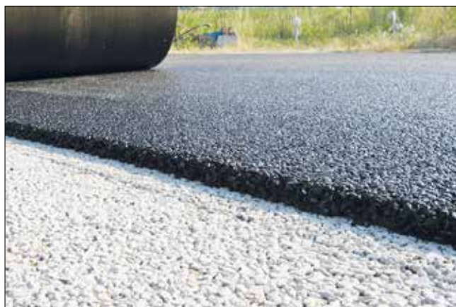
Рис. 6. Укладка сверху основания автомобильной дороги из дренажного бетона КАПСИМЭТ слоем покрытия дорожной одежды – дренажным асфальтобетоном по СТО АВТОДОР 2.15–2016 «Смеси асфальтобетонные и асфальтобетон дренажные. Технические условия»
